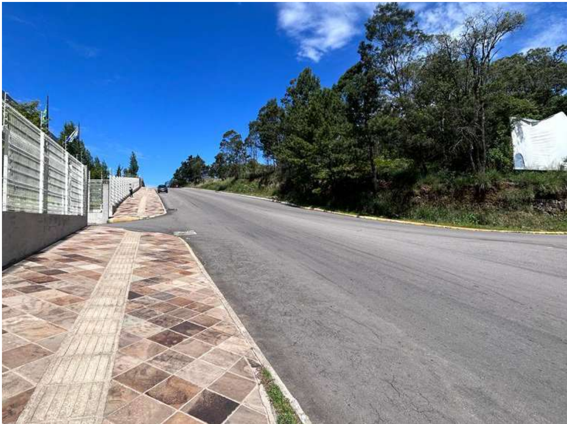
Figura 14: Imagem retiradas pela equipe técnica da Rua Fernando João Bartelle demonstrando a inexistência de iluminação pública.
