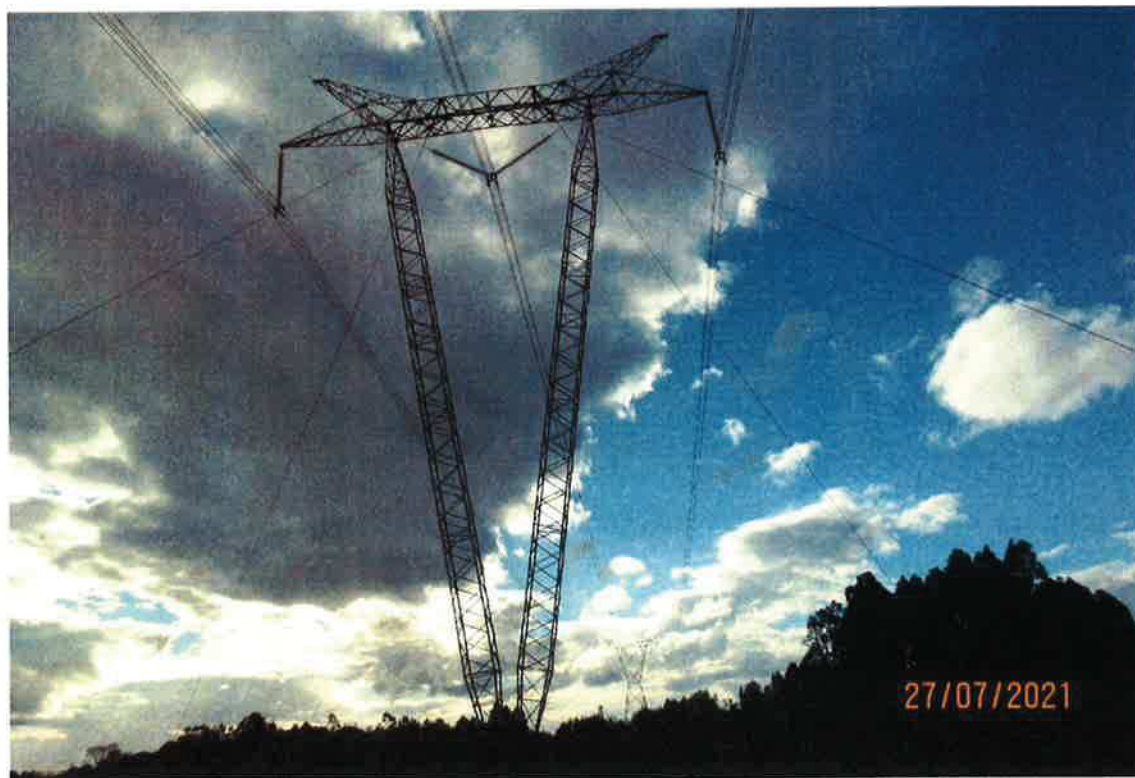
Figura 17 - Torre de energia presente na área.
