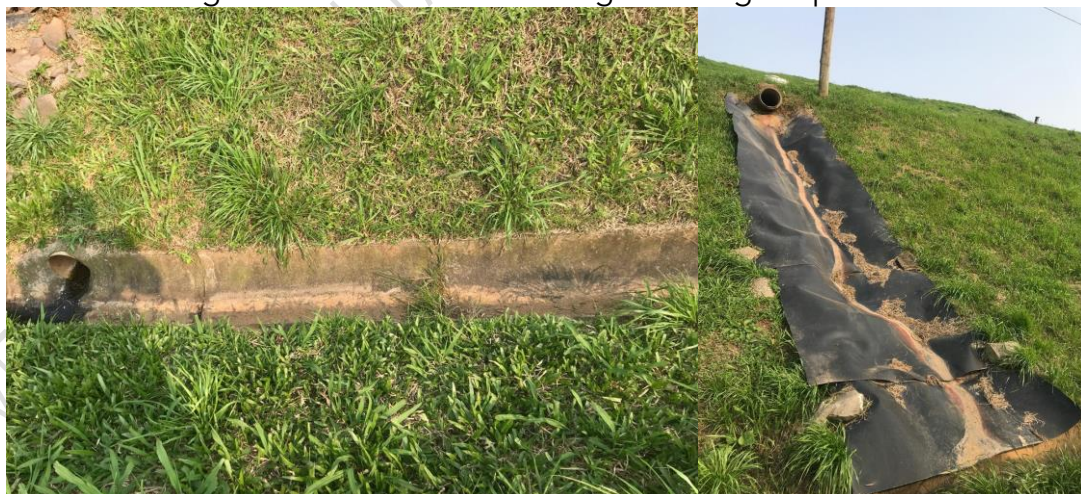
Figura 50 - Sistema de drenagem de águas pluviais
