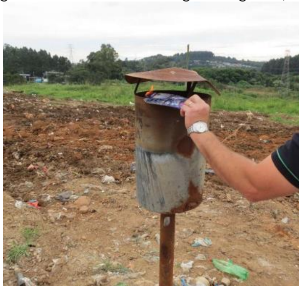
Figura 53 - Sistema de drenagem de gases ( flare )
