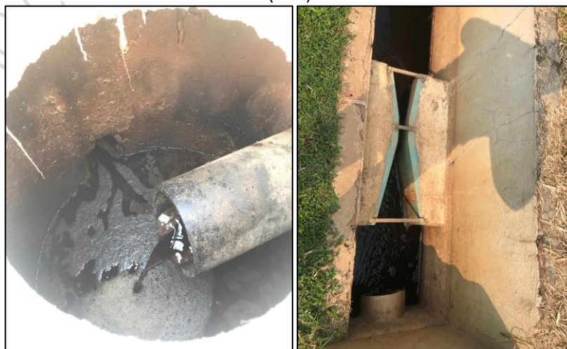
Figura 52 - Dreno de chorume (esq.); Calha Parshall de medição da vazão de chorume (dir.)
